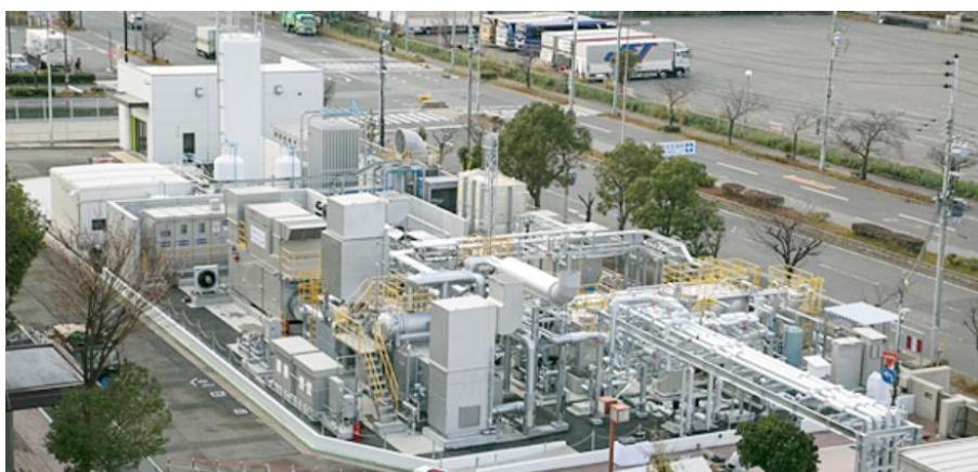
Figura 6.12 - Centrală de cogenerare urbană alimentată 100% cu hidrogen
